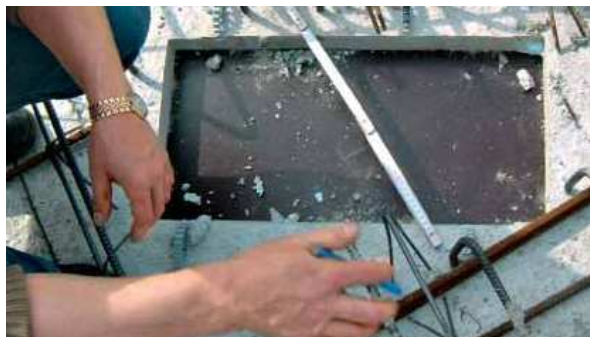
Obr 2: Otvor v debnení pre prírubu rozdeľovača
